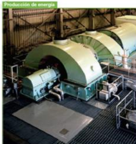
Las centrales energéticas son instalaciones industriales donde se obtiene electricidad. Es el caso de esta central geotérmica del norte de California.
